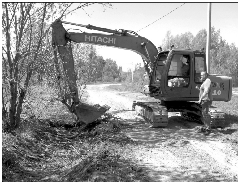
Руководитель подрядной организации А. Якушин держит на контроле темпы и качество строительных работ.
